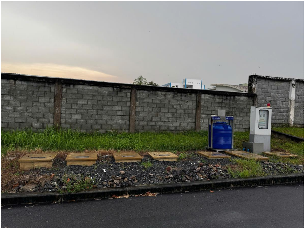
Hình 3. 4. Hệ thống xử lý nước thải tại Cơ sở
